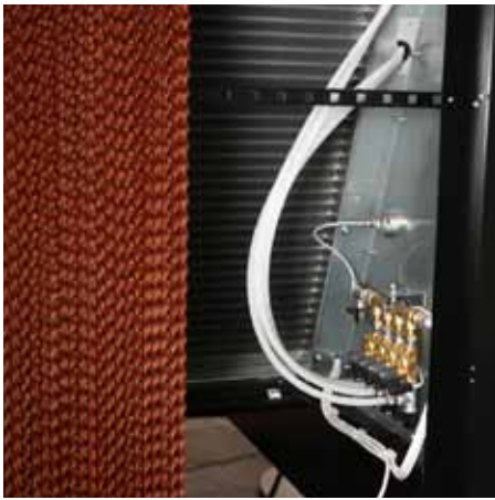
Sistema di distribuzione dell'acqua ai pacchi adiabatici Water spraying system to the adiabatic packs Wasserverteilungssystem zu den adiabatischen Füllkörperpaketen
